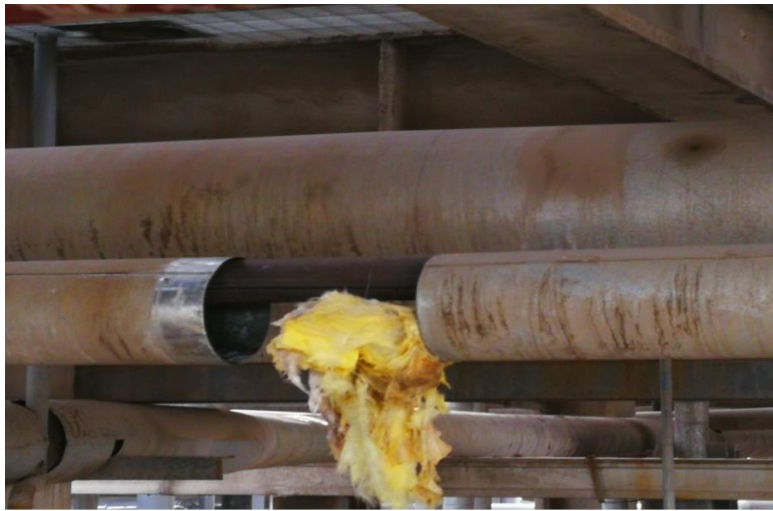
平衡线冻裂情况
