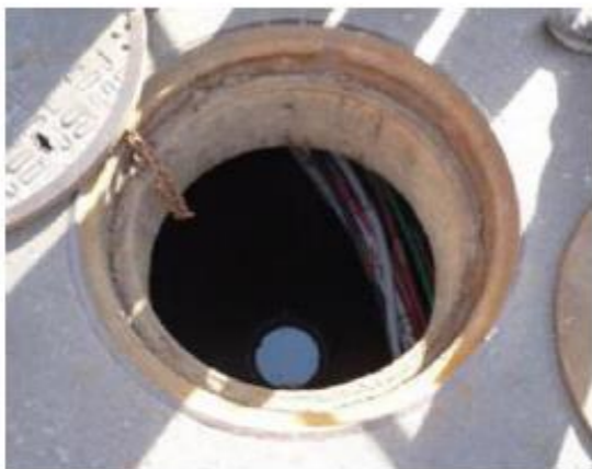
(d) 电力电缆井
