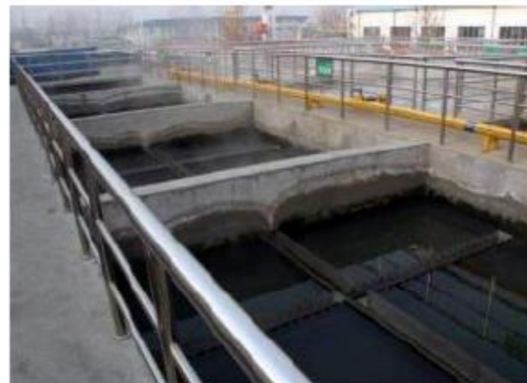
(f) 污水处理池
